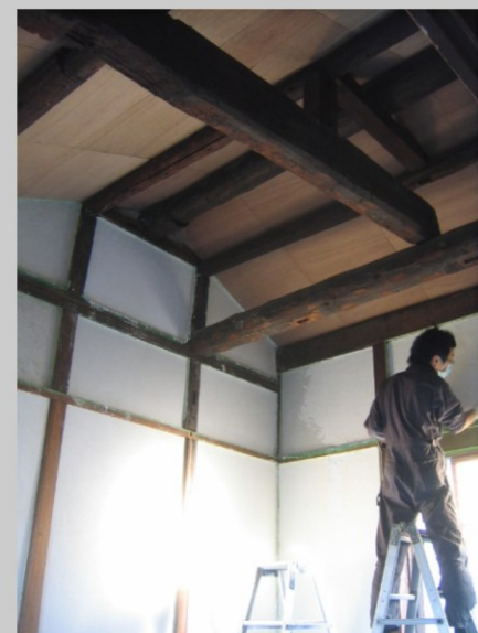
■施工中の写真-3 2階既存天井を解体して小屋裏を見せる。野地板裏に断熱材を施工+ラワン合板仕上げ。壁は漆喰金ゴテ押え仕上げ。
